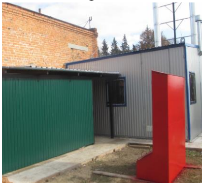
Котельня Холминської ЗОШ І-ІІІст.
